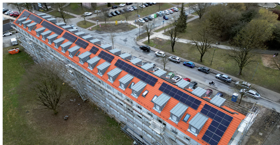
Wir investieren in energetische Sanierungen – wie hier in der Bradleystraße in Neu-Ulm.
